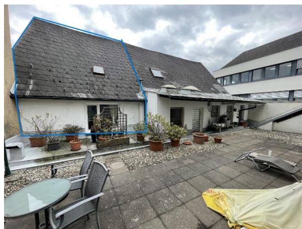
Dachterrasse, Blick zu Haus 1a, blau umrandeter Bereich gehört zur gegenständl. Liegenschaft, ist aber nur über Nachbarliegenschaft erreichbar!
